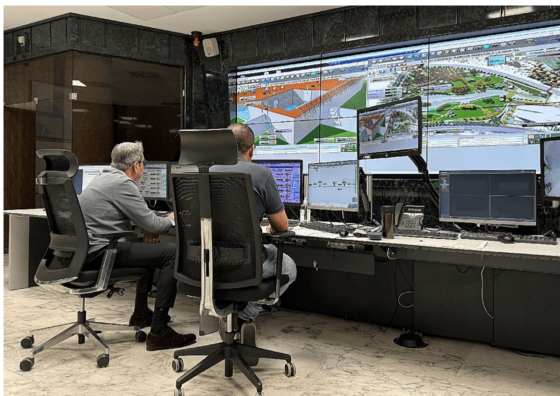
Imagen del centro de control ABC
